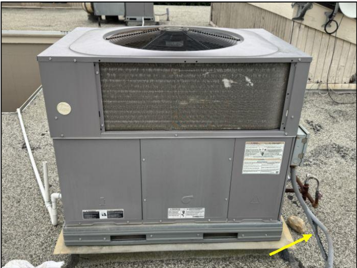
electrical conduit damage
